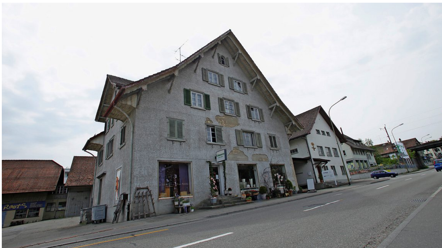
Das ehemalige Landihaus an der Usterstrasse 23. Die einen wollen es erhalten und renovieren, die anderen abreissen. Archivfoto: D. Caspari
